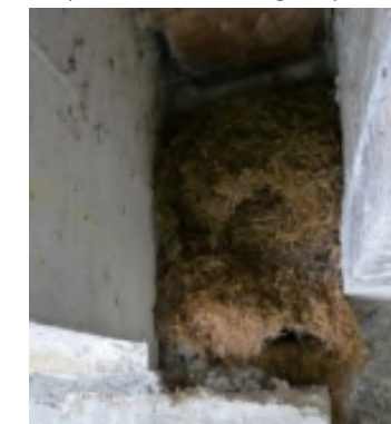
Nids de cincle sur une pile de pont (photo : J. Giraud-Claudon)
